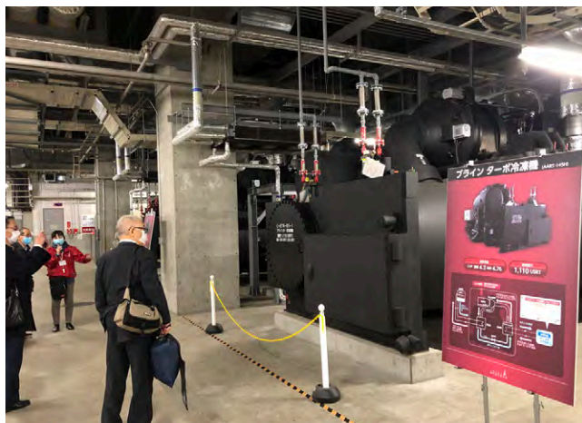
地下設備（地下5階）
